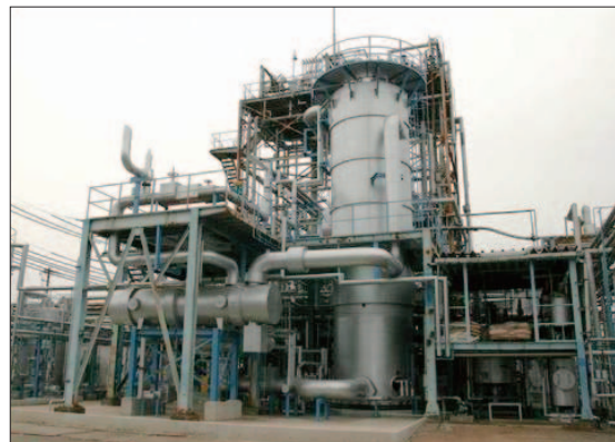
(ビスフェノールF製造設備)
