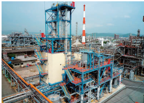
精製BHT製造設備
