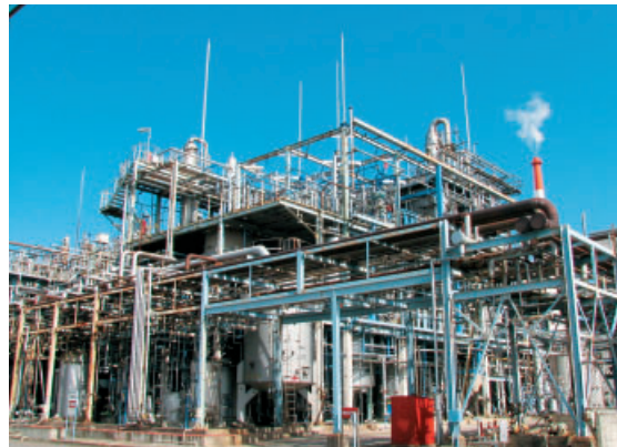
(特殊ビスフェノール製造設備)
