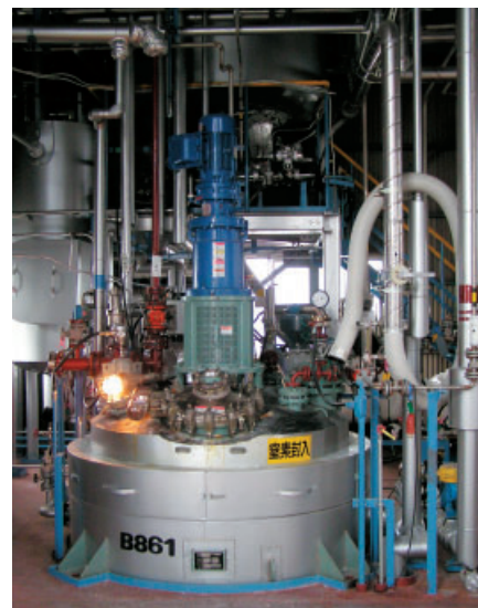
(今回増設したメタルフリー化設備)
