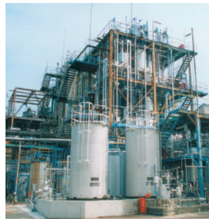
(液晶原料の製造プラント)
